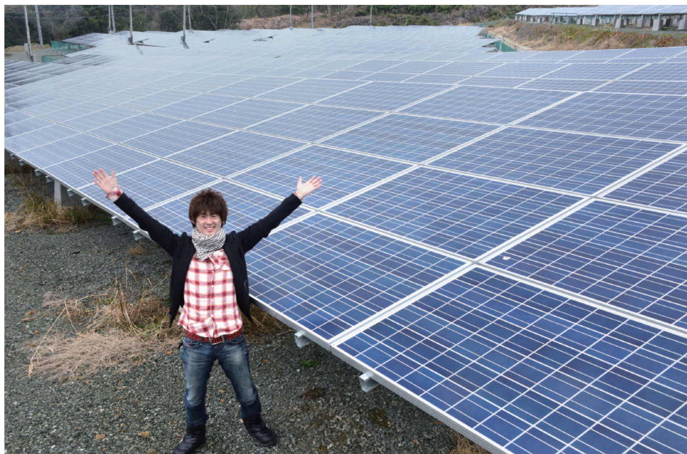
分譲型太陽光発電所にて。太陽光事業における土地開発なども行っている
