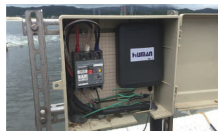
自社開発のIoT機器実証実験設備
